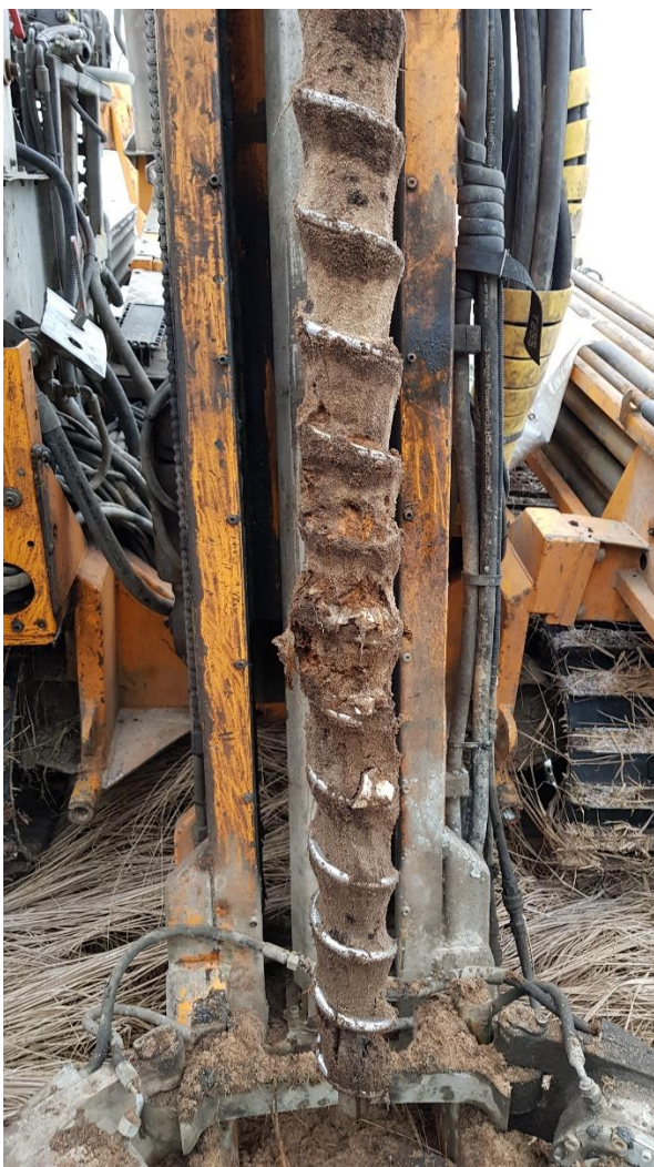
Figur 6. Provpunkt NC3 på 1 - 2 m djup. Tydlig lukt av organiskt nedbrutet material. Avfallsrester som porslin, plast etc.
