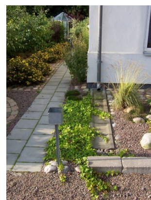
Takvattenutkastare, Dagvattenutredning Åmot 2:4, Ramböll, 2019 .
